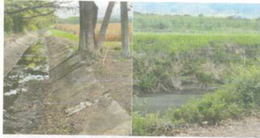
Imagen 7: Placas de concreto sueltas y estado actual del talud del canal de drenaje principal.
